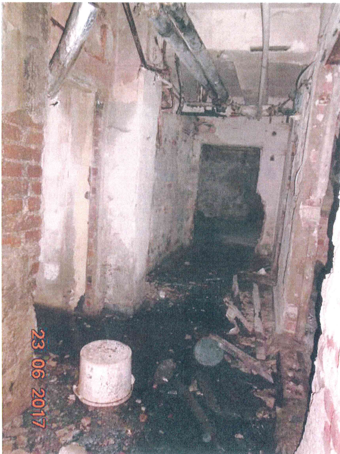
Foto 9 – subsol inundat, exfolieri ale tencuielilor, zidarie degradata, improvizatii la instalatii
