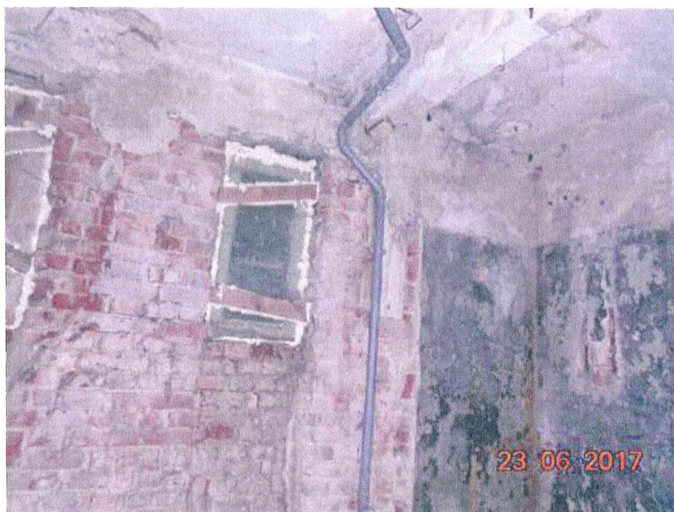
Foto 6 – la subsol- tencuili degradate aproape in totalitate , zidarie partial degradata
