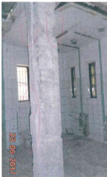
Foto 1 - beton degradat in stalpi tronson 2 la nivelul parterului
