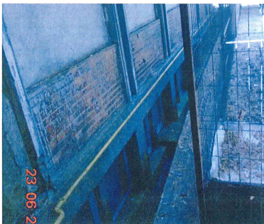
Foto 4 – curtea interioara a tronsonului 2 – nu este asigurata scurgerea apelor pluviale, astfel se infiltreaza la subsol
