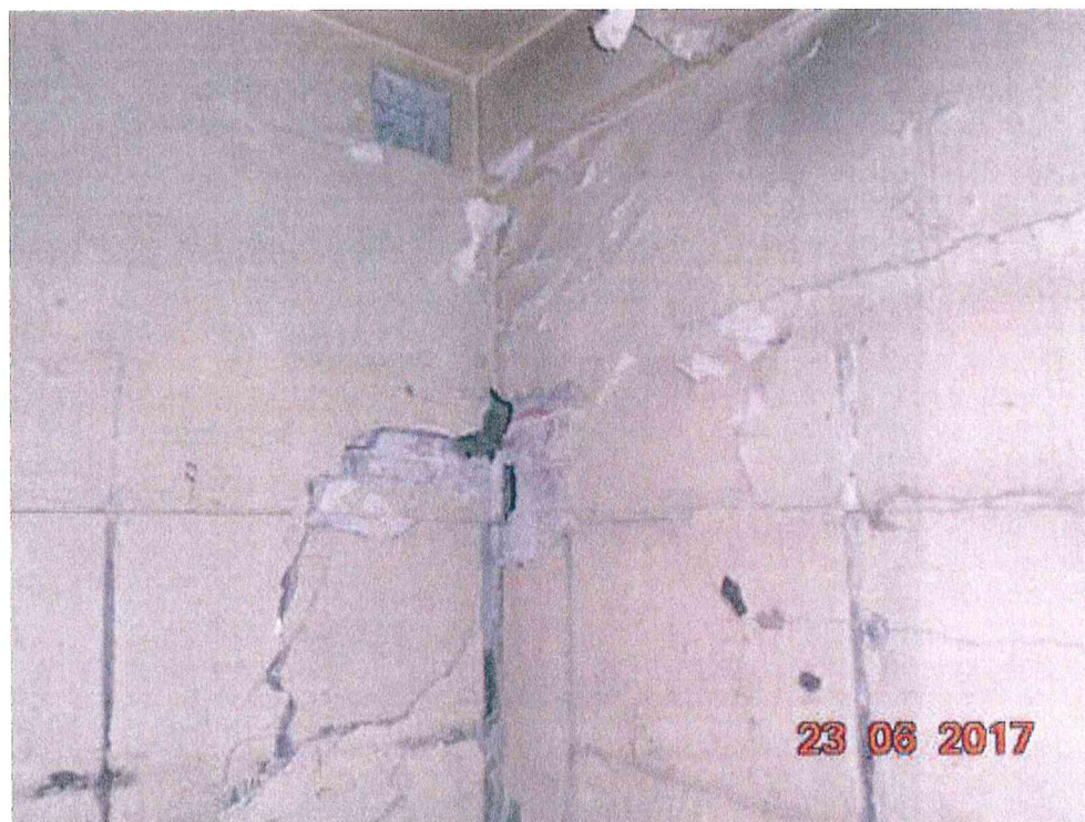
Foto 8 - fisuri in pereti la subsol
