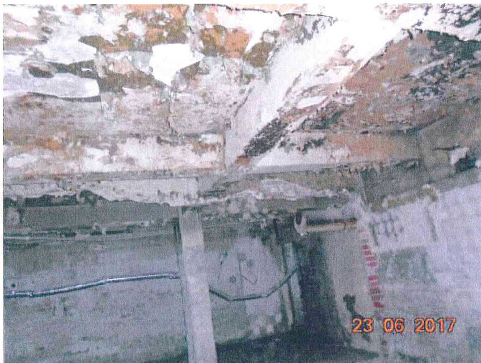
Foto 7 - subsol inundat, exfolieri ale tencuielilor, improvizatii la instalatii
