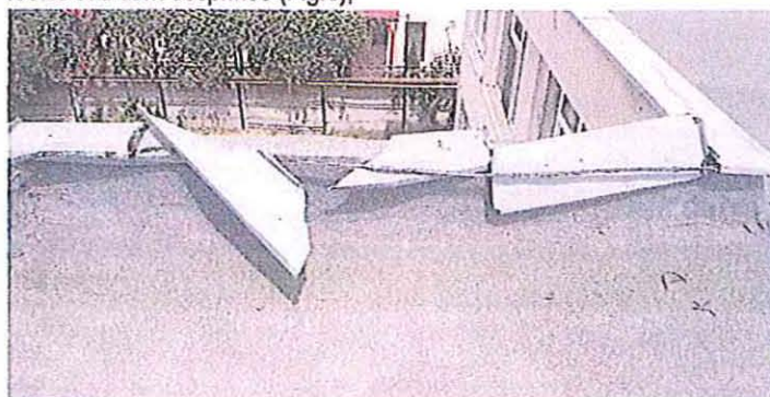
Fig. 5-Sorțuri de tablă degradate/desprinse
