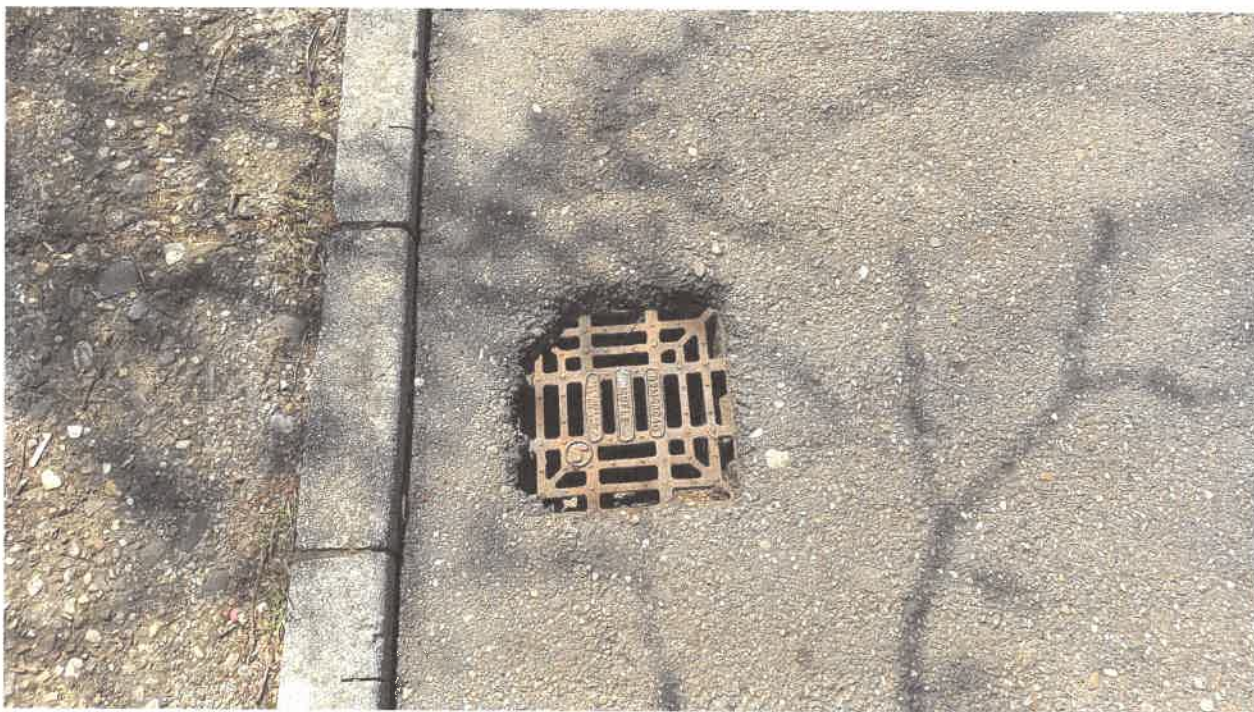
Fig. 12 Gura colector ape pluviale
