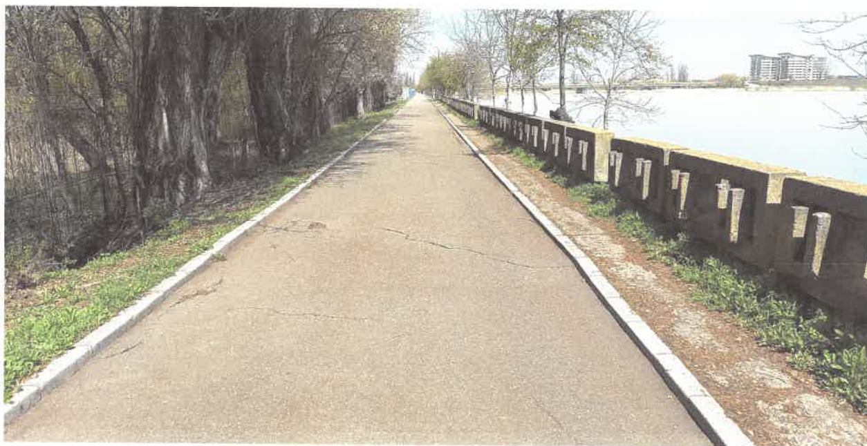
Fig. 11. Zona cu asfaltul de pe coronament fisurat de radacini
