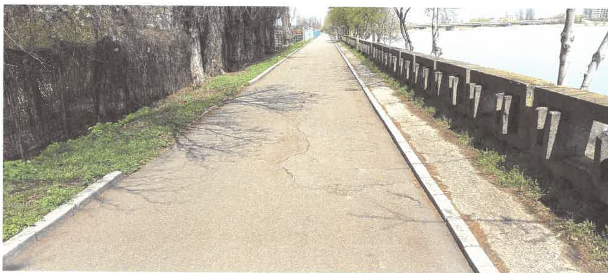
Fig. 10. Zona cu asfaltul de pe coronament fisurat de radacini
