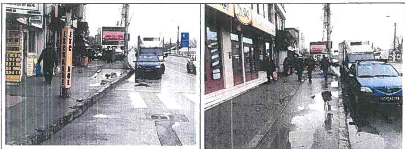
Bdul Unirii Segm.3. Trotuar degradat, borduri ciobite, apele stagnează pe trotuar si carosabil, carosabil cu plombe
