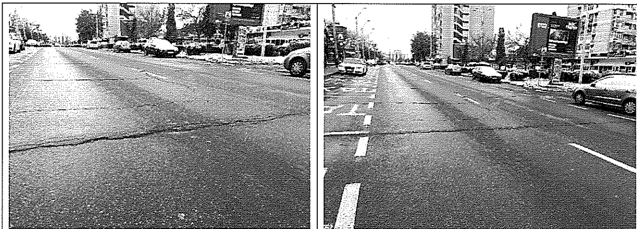
Piața Gării Segm.6. Carosabil degradat transversale adânci
