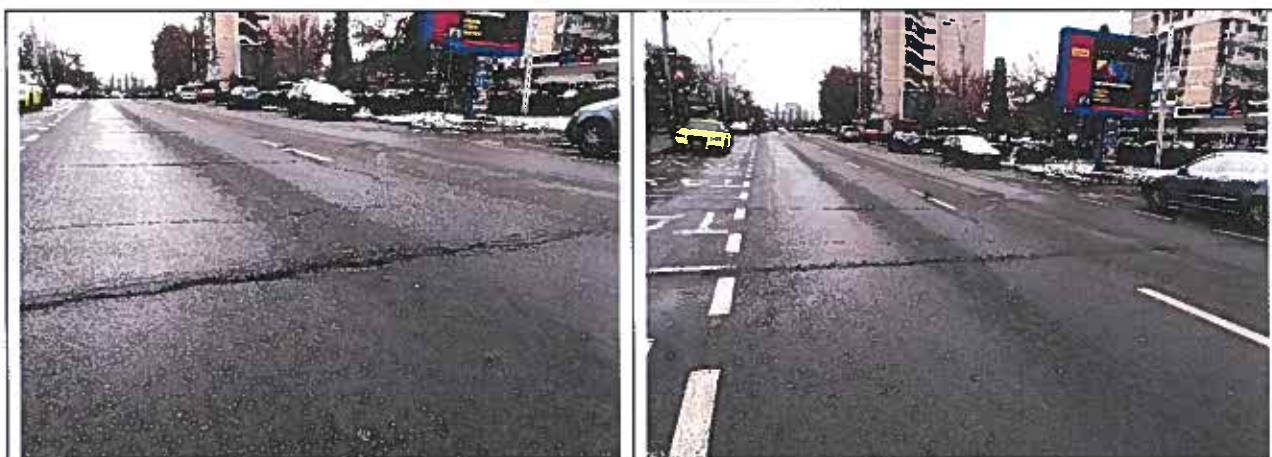
Piața Gării Segm.6. Carosabil degradat transversale adânci
