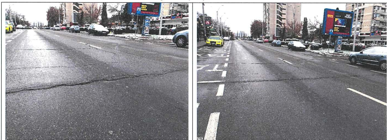
Piața Gării Segm.6. Carosabil degradat transversale adânci
