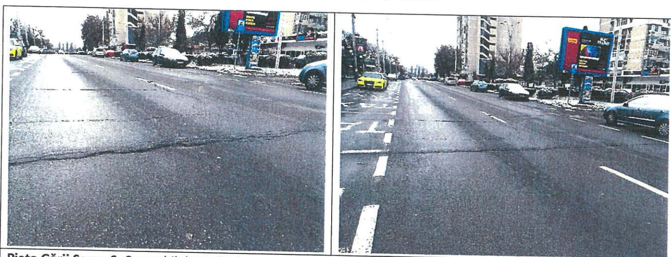
Piața Gării Segm.6. Carosabil degradat transversale adânci
