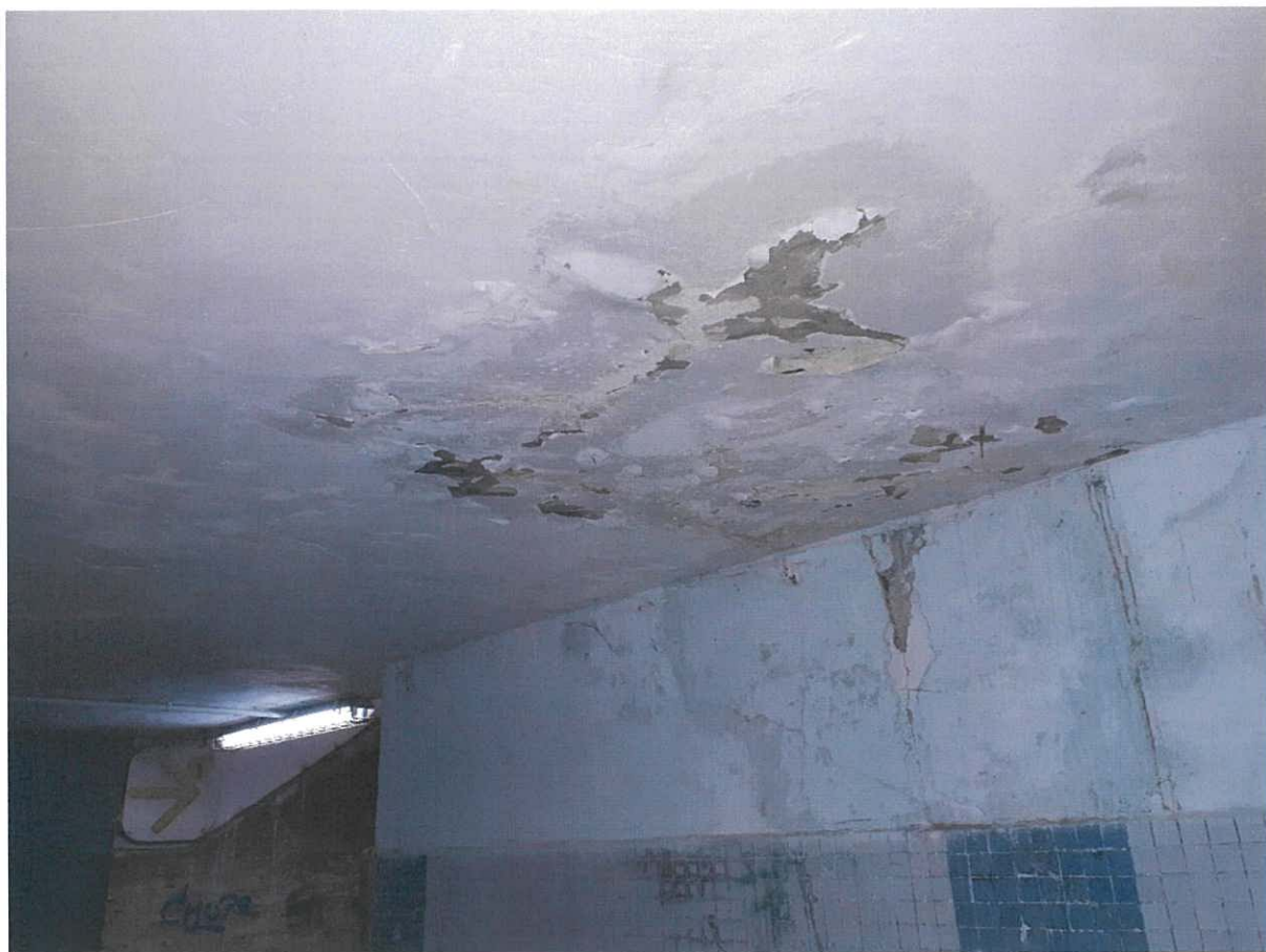
Foto 11: Detaliu intrados planseu pe zona dintre gara si accesul pe peroane
