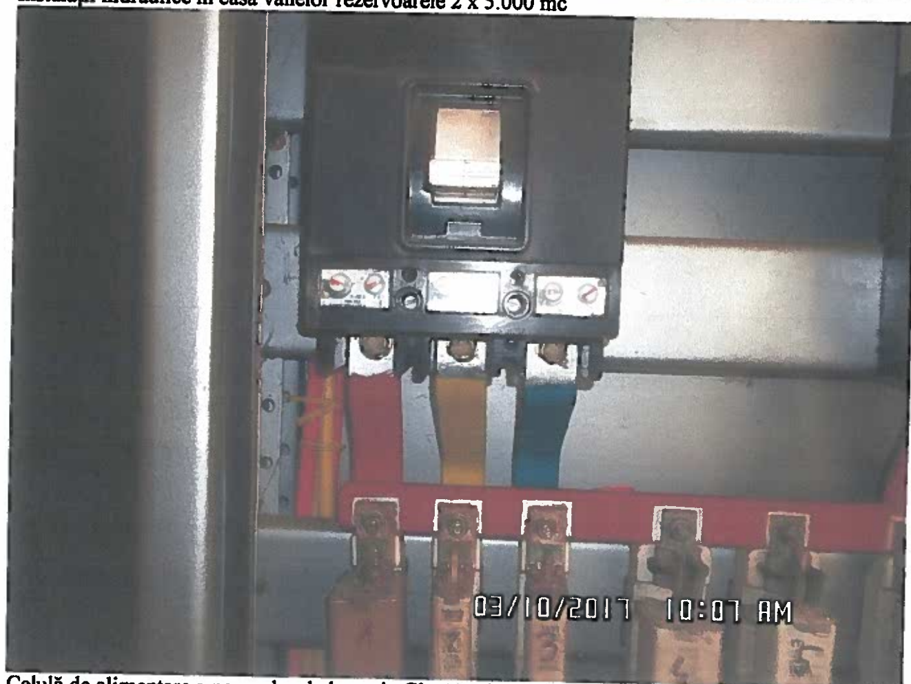
Celulă de alimentare a pompelor de la stația Gherăiești
