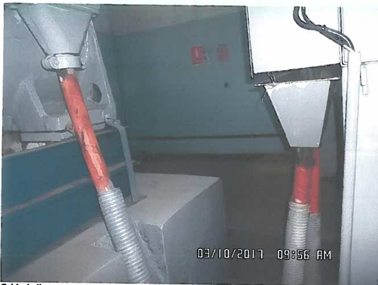
Cabluri alimentare motoare stația de pompe Gherăiești
