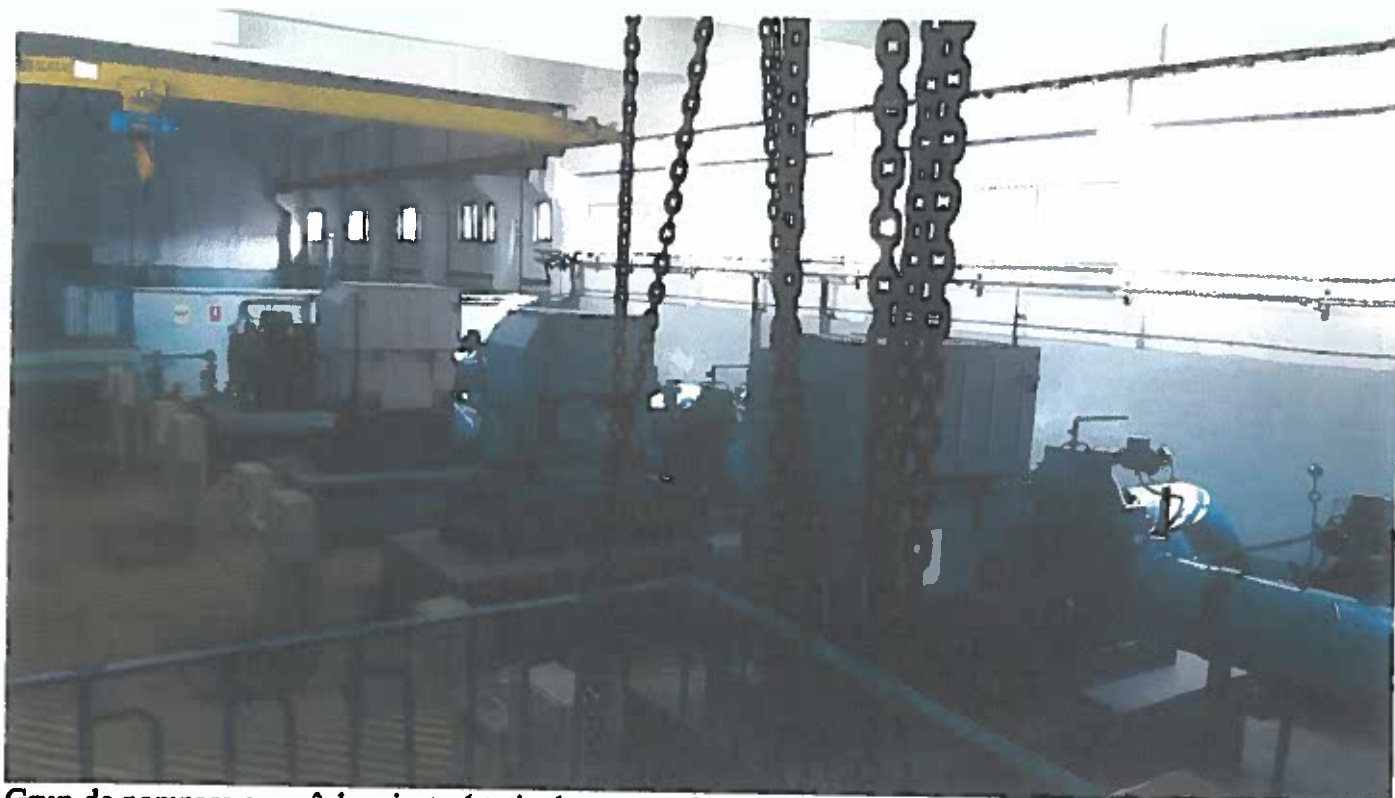
Grup de pompare ce se înlocuiește (stația de pompe Gherăiești)
