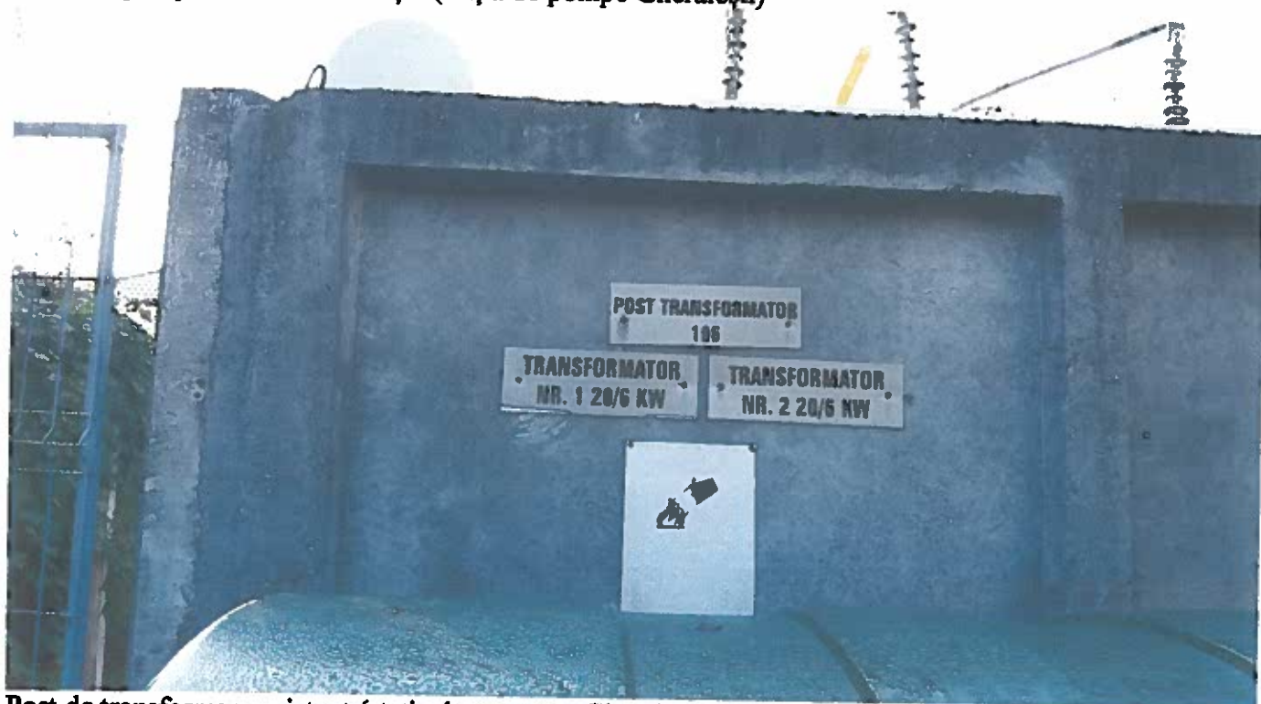
Post de transformare existent (stația de pompare Gherăiești)
