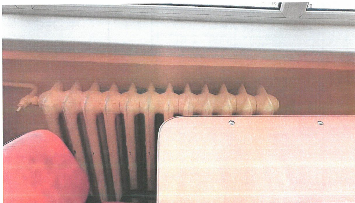
Corpuri statice cu armatura de reglaj blocata, nu se poate efectua reglajul tur-retur si aerisirea corespunzatoare a instalatiei
