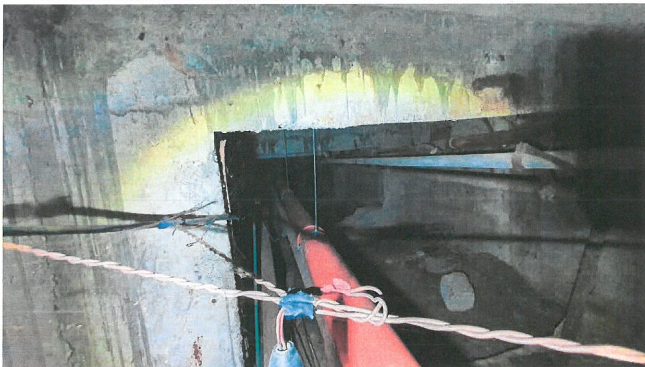
Subsol tehnic – se va dispune o ventilatie a subsolului pentru eliminarea umiditatii datorate lipsei de ventilare
